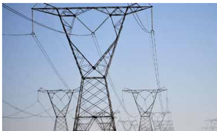
O objetivo das medidas preventivas é aumentar a confiabilidade do sistema elétrico brasileiro.
