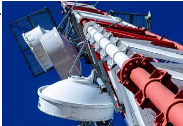
A instalação das novas antenas do 5G difere das tecnologias anteriores, já que necessitam de densidade maior de replicadores de sinal.
