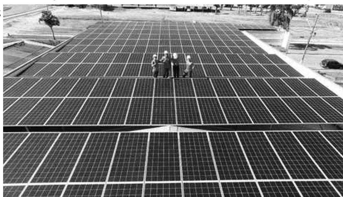
Projeto fotovoltaico da Bluesun Solar do Brasil.
