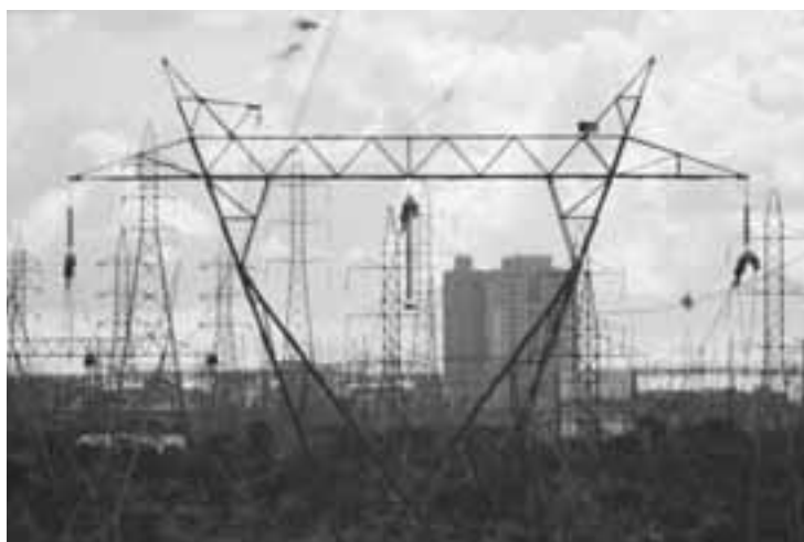
Mais de 1.700 km de linhas de transmissão foram agregados ao Sistema Interligado Nacional.
