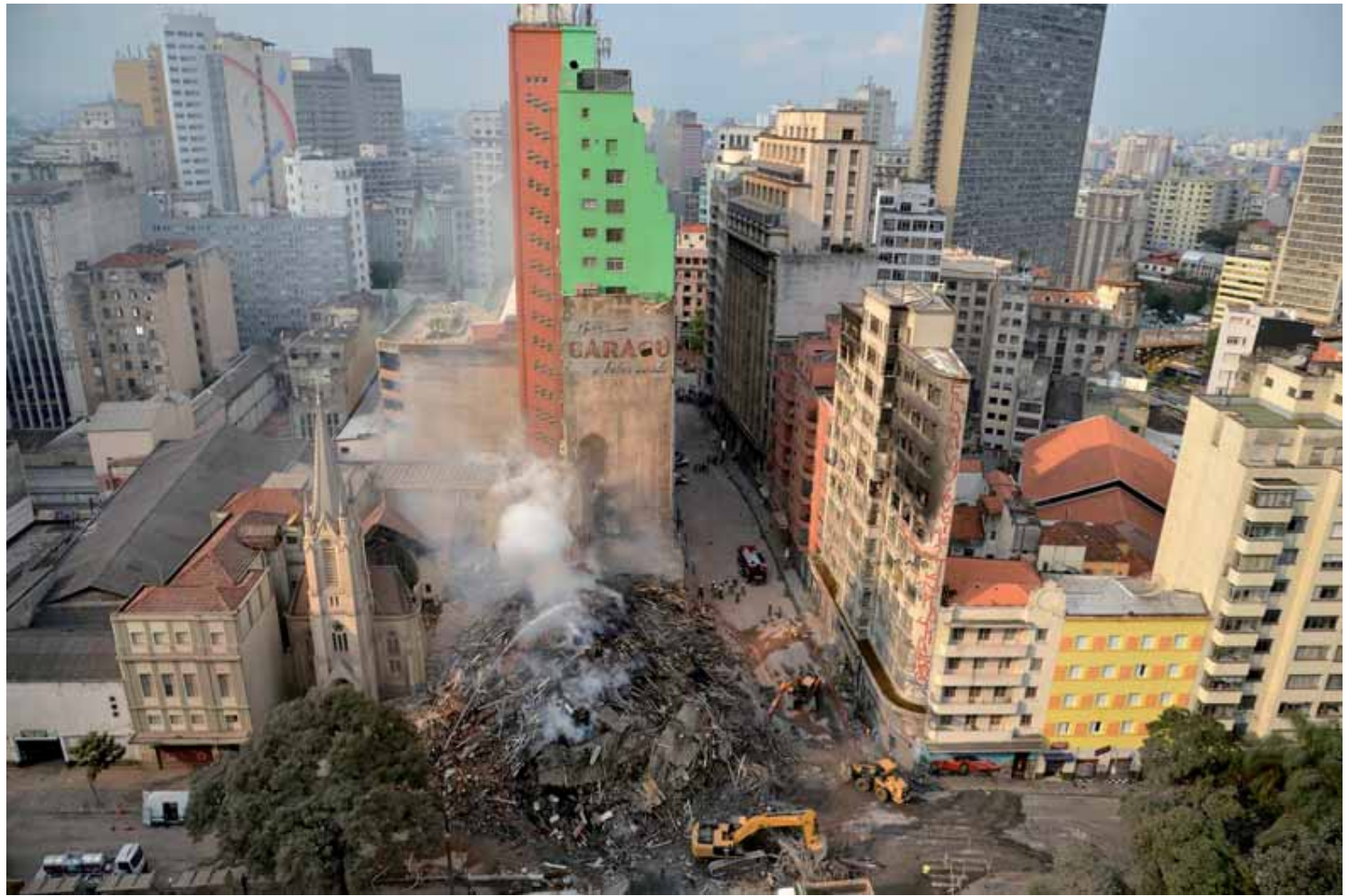
Desabamento Edifício Wilton Paes de Almeida deixou 7 mortos.
